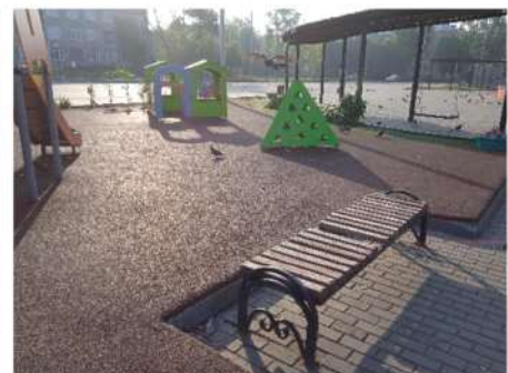
Низкое качество изготовления элементов благоустройства
